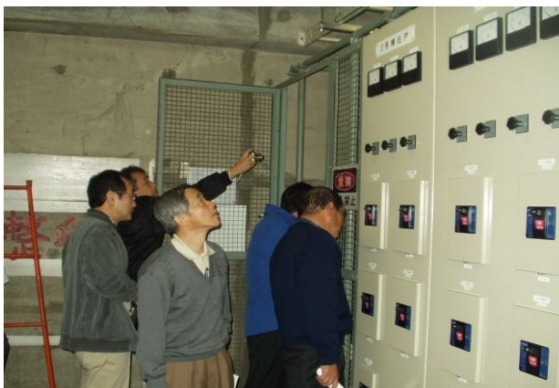
1・3号棟電気室
